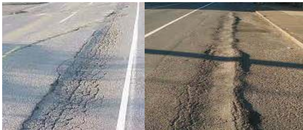
شکل ۴. نمونه‌ای از خرابی شیارشدگی
