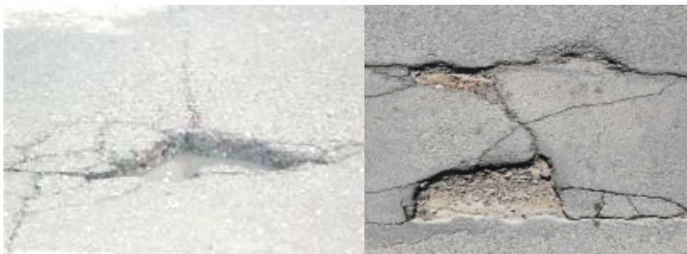
شکل ۶. نمونه‌ای از خرابی چاله
