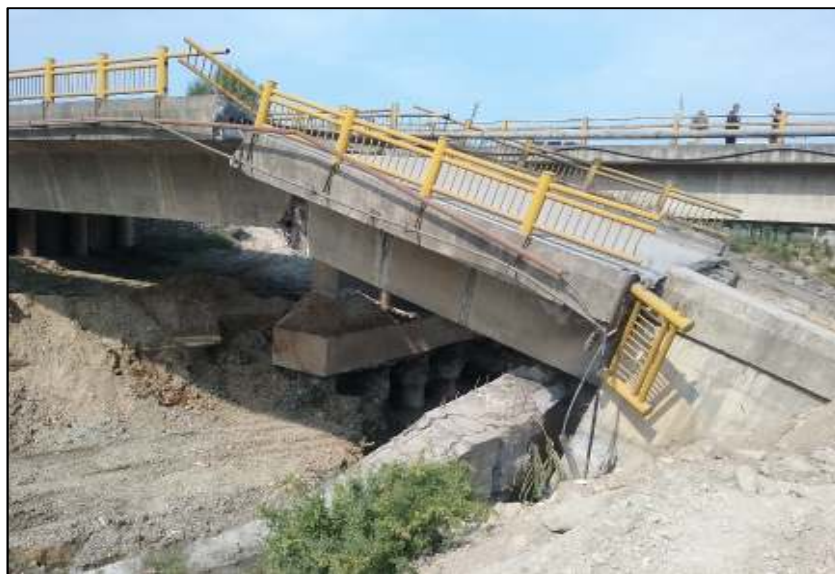
شکل ۲. آبشستگی زیر کوله و شکست عرشه، سیل ۱۳۹۷، پل کمربندی نوشهر
