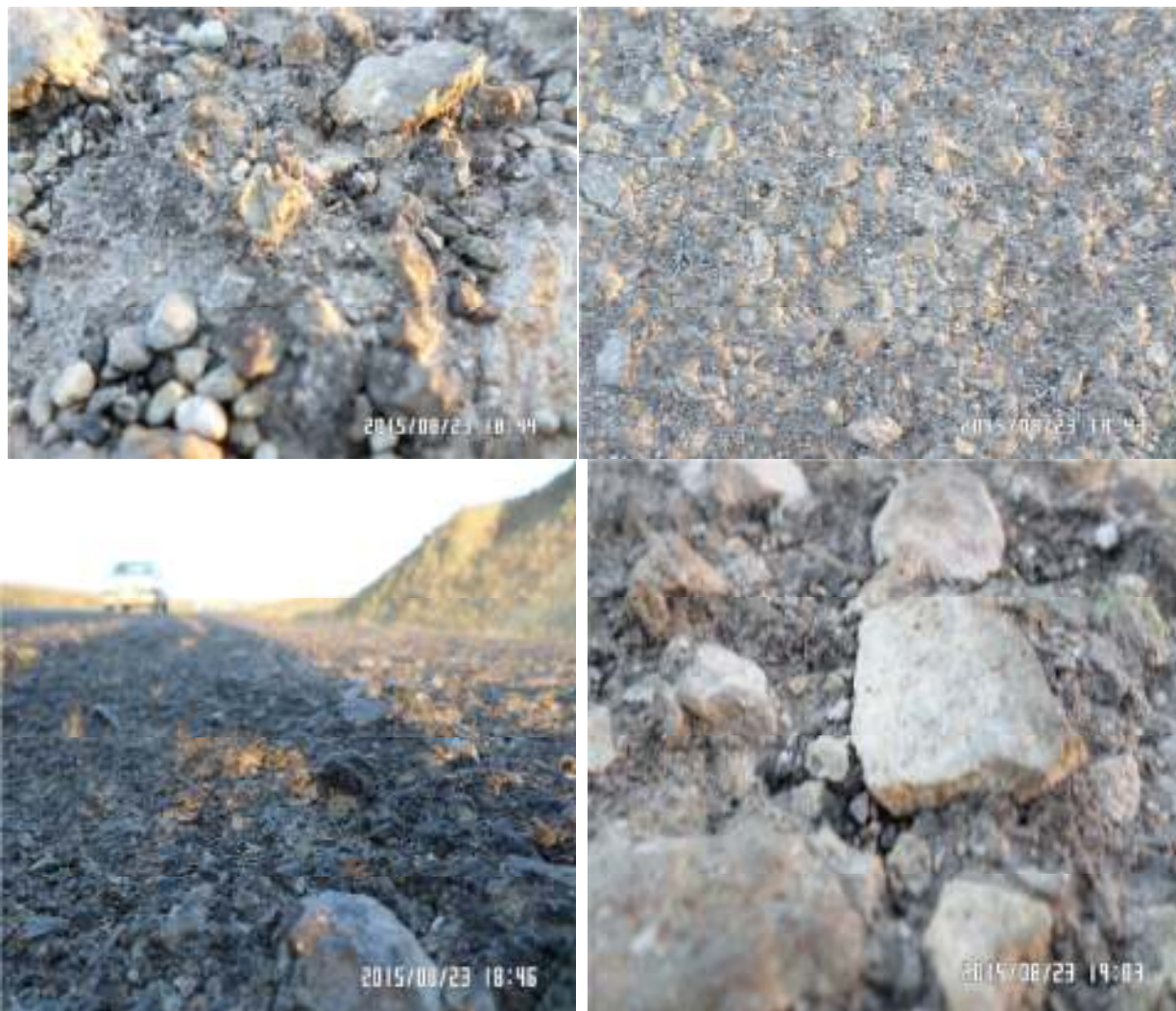
شکل ۳. نمونه هایی از کیفیت سطحی آسفالت قطعه شماره ۱ و وقوع خرابی عریان شدگی
