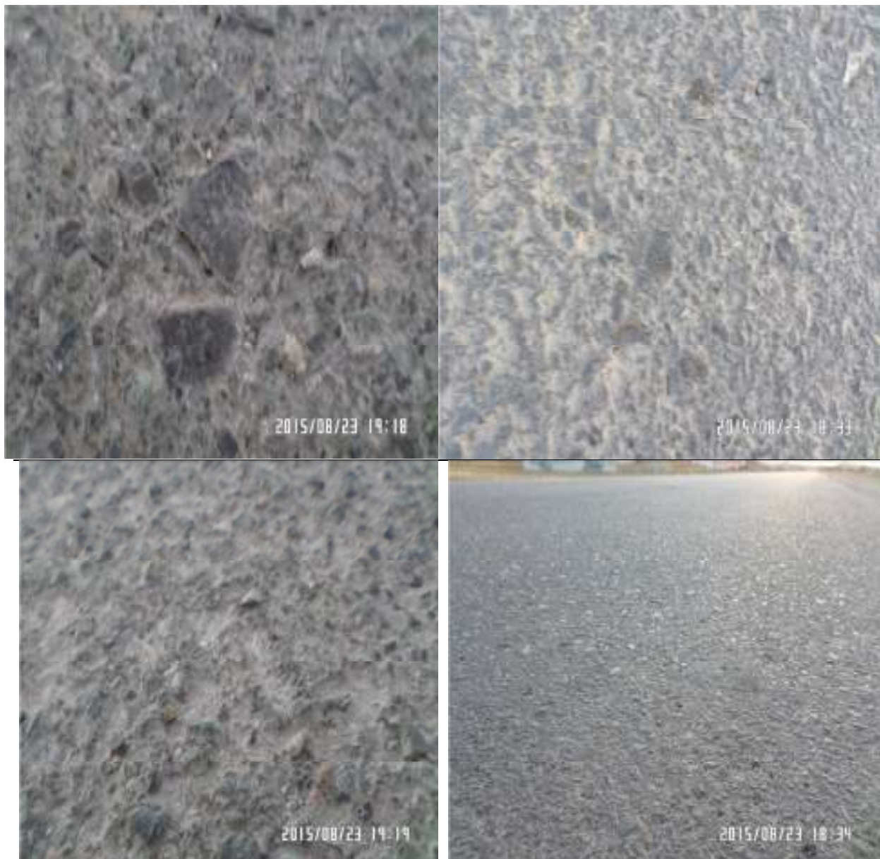
شکل ۴. نمونه‌هایی از کیفیت سطحی آسفالت قطعه شماره ۲ و انسجام سطحی آن
