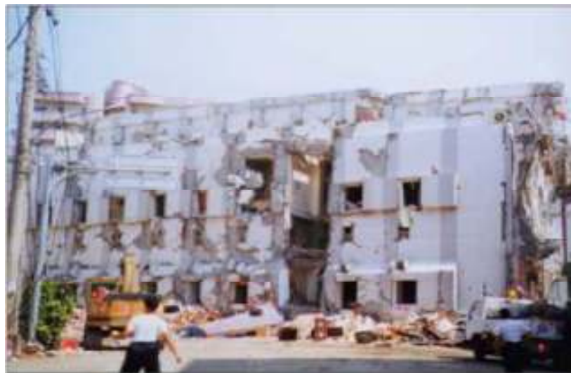
شکل ۸ خرابی در اثر ناپایداری (ساعدی، ۱۳۸۹)
