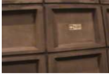
(الف) نحوه نامناسب استفاده از نشانگرها (تونل توحید)
