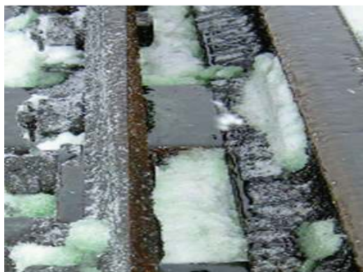
شکل ۷. استفاده از ضد یخ در سوزن خطوط ریلی
