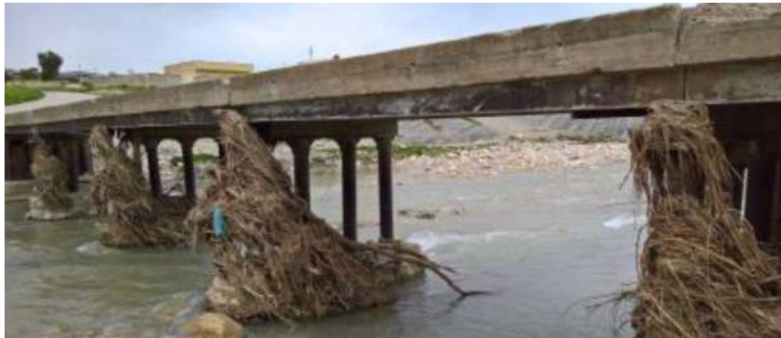
شکل ۲. تجمع آشغال و الوار در اطراف پایه پل در سیلاب فروردین ۱۳۹۸ (غلامی و همکاران، ۱۳۹۸)
