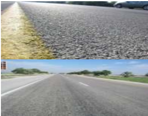
شکل ۱۵. روسازی پس از گذشت حدود ۲ سال از اجرای لایه حفاظتی چپ سیل در باند عبوری محور چغادک-خورموخ (حد فاصل روستای قباکلکی تا دمربادان)
