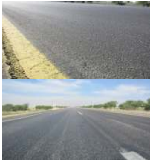
شکل ۱۷. روسازی پس از گذشت حدود ۲ سال از اجرای لایه حفاظتی فوگ سیل در باند عبوری محور خورموج-چفادک (حد فاصل سه را گادویی تا چفادک)
