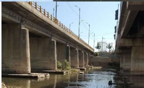
شکل ۵. در اثر آبشستگی رخ داده، لبه‌های پی کمی دیده می‌شود.
