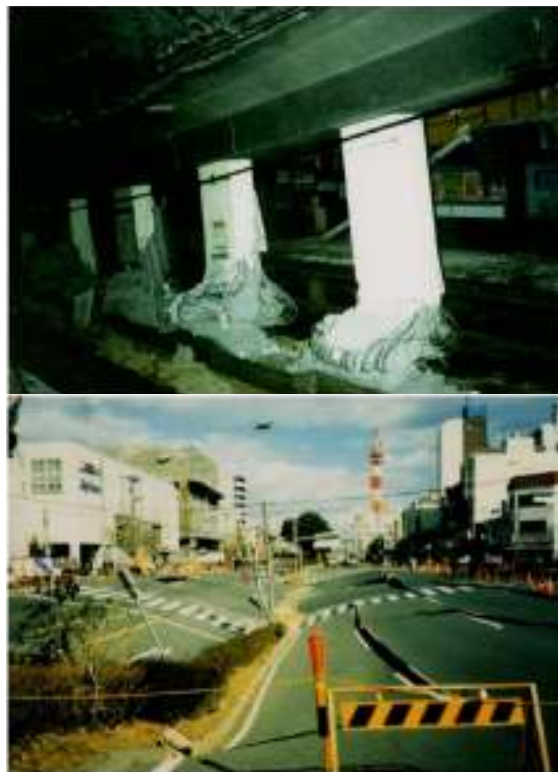
شکل ۲. خرابی ایستگاه مترو در زلزله سال ۱۹۹۵ کوبه ژاپن (الف) ستون‌های آسیب‌دیده؛ (ب) فرونشست سطح زمین (Uenishi and Sakurai, 2000)
