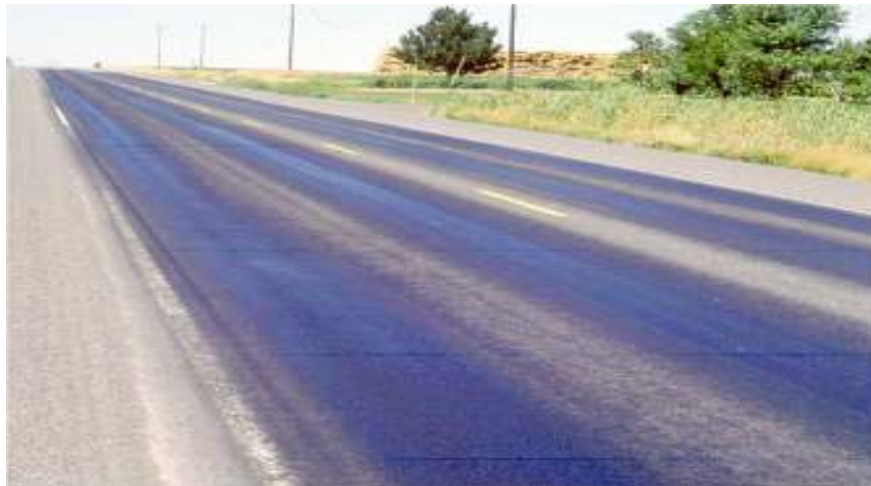
شکل ۲. قیرزدگی در رویه‌های آسفالتی
